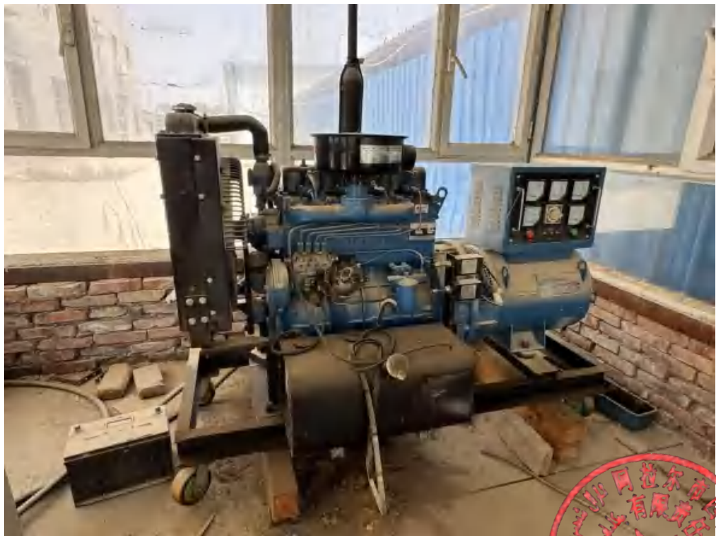
配备备用电源及冗余系统确保考试不间断应急设备
